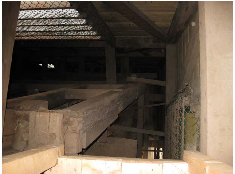
Afbeelding 13: foto, naar beneden genomen in de ZO hoek van de toren. De oude toren (links-onder) staat scheef.
