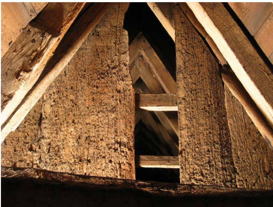
Afbeelding 10: restant in de nok van een tijdelijke afdichtingswand met restanten van leibekleding
