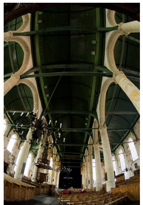
Afbeelding 53: het hout van de hele kapconstructie was danig aangetast door de bonte knaagkever.
