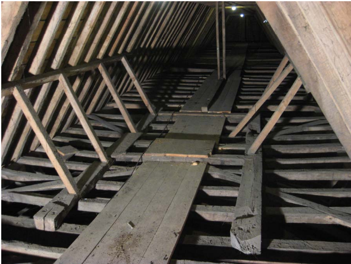
Afbeelding 54: Op deze foto, die genomen is op de nokzolder van de middenkap, is de fundering van de dakruiter te zien, die tot 1740 op het dak stond. Duidelijk is dat het gewicht van dat torentje verzakkingen in de constructie heeft veroorzaakt.
