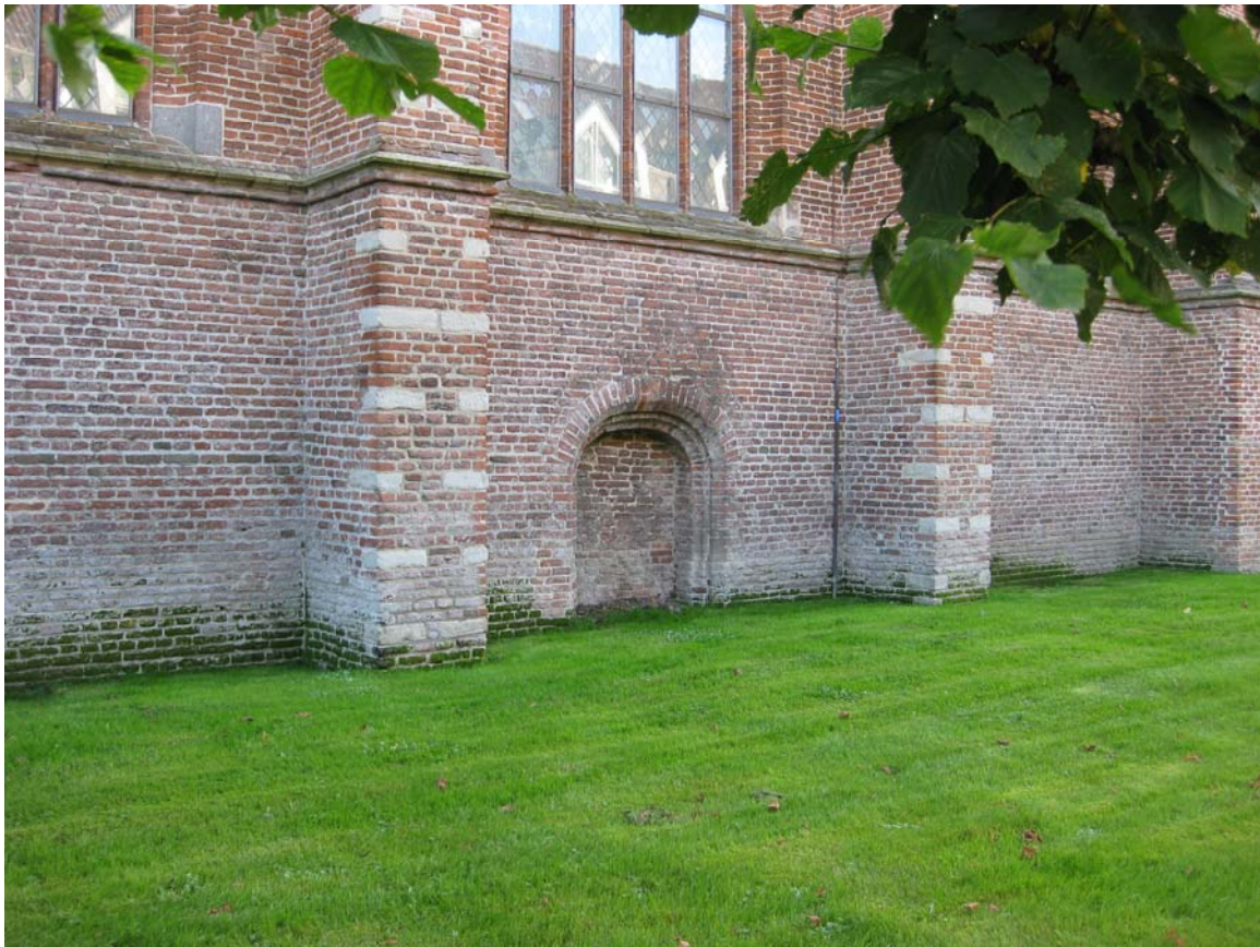
Afbeelding 56: door het begraven in en buiten de kerk en door grondaanvullingen kwam het maaiveld en de vloer van de kerk omhoog. Dat is te zien aan deze dichtgemetselde deuropening aan de noordzijde van de kerk. De opening bevindt zich in het oudste gedeelte van het gebouw. Ook de onderste trede van de spiltrap in de zuidelijke traptoren zit ver onder het huidige straatniveau. Bij de laatste bouwphase en bij de bouw van de portalen is rekening gehouden met het hogere maaiveld.
